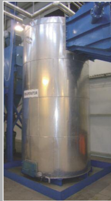
Chaudière à eau chaude Hot water boiler
