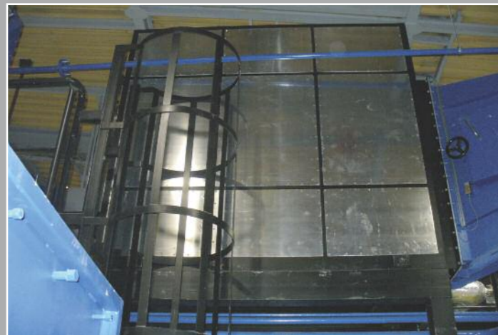
Chaudière à vapeur / Steam boiler
