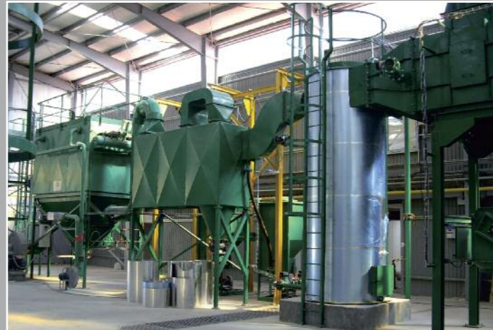
Exemple de neutralisation et filtration par voie sèche – conformes aux normes européennes. Example of neutralization and filtration by dry method – in conformity with European Norms.
