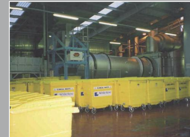
Usine d'incinération de déchets médicaux Incineration plant for medical waste
